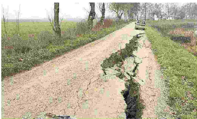
Il cedimento sulla via comunale per Burana
