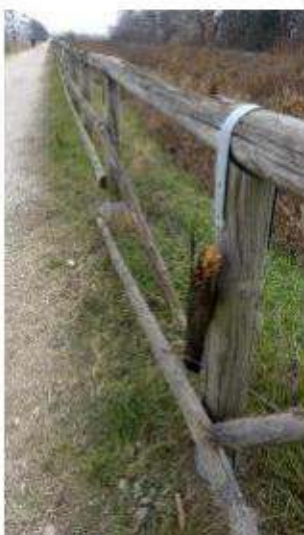
Un tratto danneggiato
