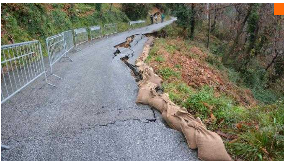
Pietrasanta, frana la strada a Vitoio (Foto Umicini)
