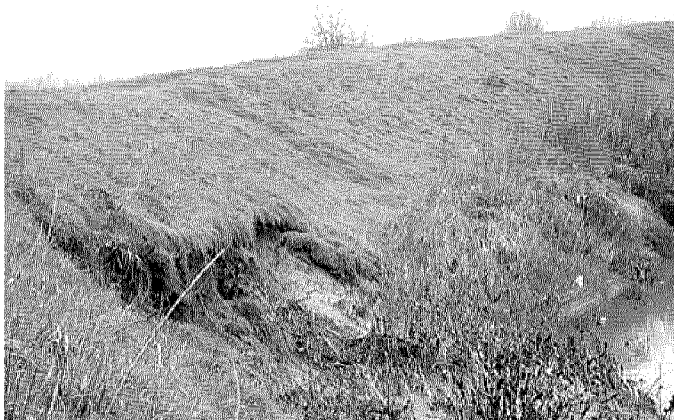
Un tratto di argine franato in seguito alle ultime piene
