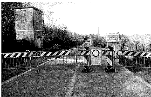
La strada provinciale 77 di Rovolon, minacciata da una frana foto Piran
