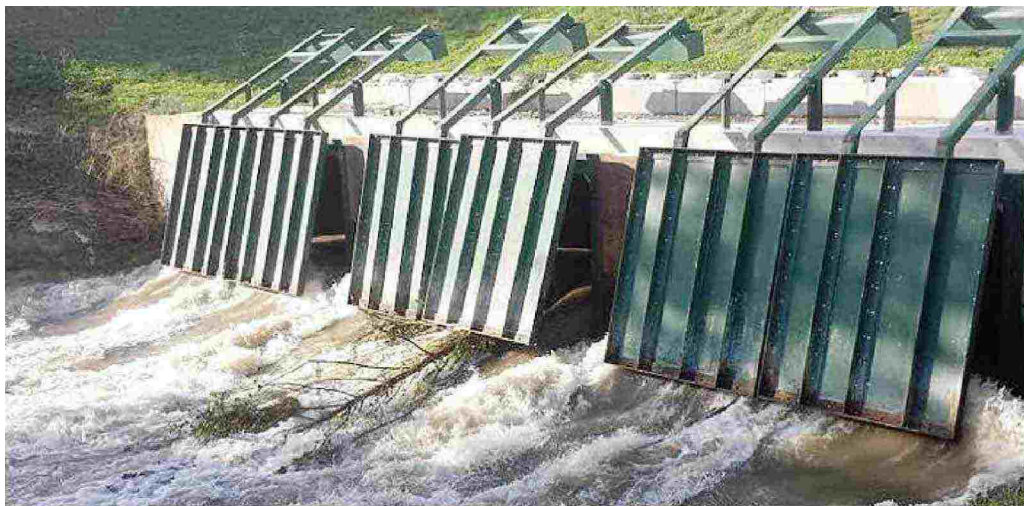
Il tronco di un albero si è infilato fra le paratie installate sull'Ozzeri: è uno di quei casi che verrà segnalato
