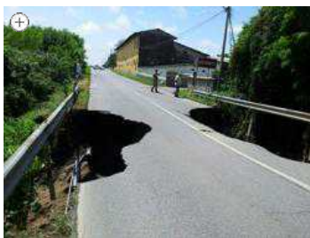
Il crollo del ponte sul torrente Zender lungo la strada provinciale 159 Bottanuco-Madone
