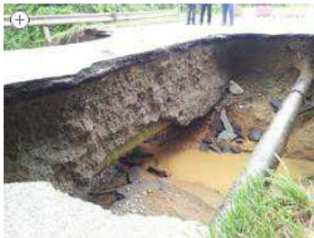
Il crollo del ponte sul torrente Zender lungo la strada provinciale 159 Bottanuco-Madone
