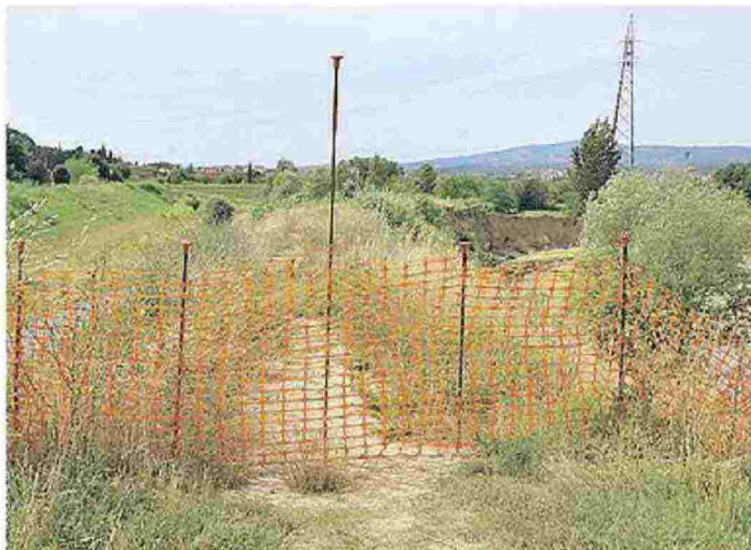
PERICOLO La zona franata sull'argine dopo le piogge di questo inverno
