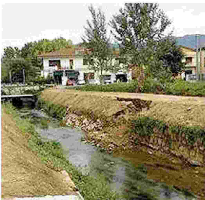
L'argine franato sul rio Casale
