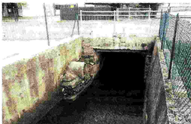
Il ponte causa un effetto imbuto con effetto tappo al deflusso
