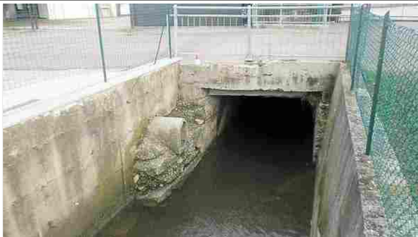
Il ponte causa un effetto imbuto con effetto tappo al deflusso
