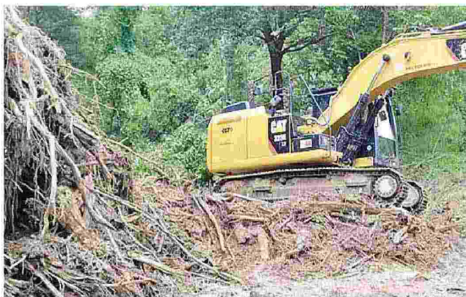
I danni dell'alluvione lungo la Freddana (Vip)
