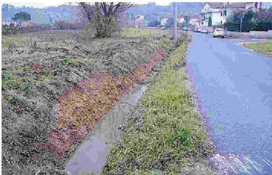
SICUREZZA IDRAULICA Il Rio Vallebuia ha provocato non pochi problemi a Botteghe
