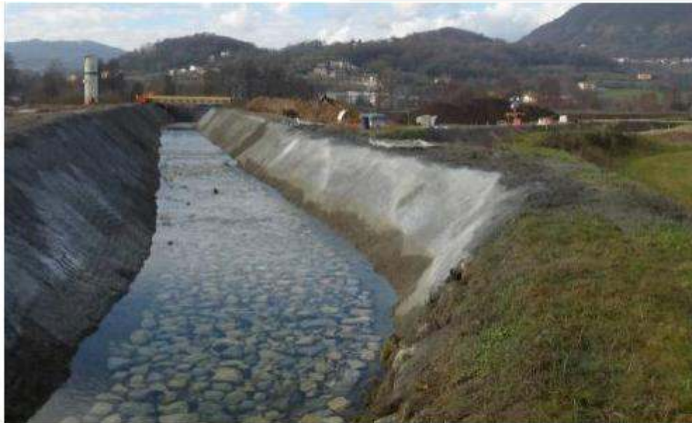
I lavori per modificare il corso del torrente Poscola sono terminati puntualmente. A.C.
