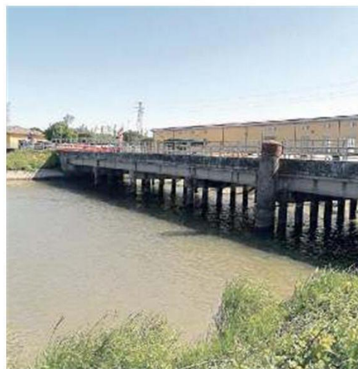
CAVANELLA PO Il nuovo ponte non sarà pronto prima di fine 2022: in alto, uno dei piloni ammalorati della struttura
