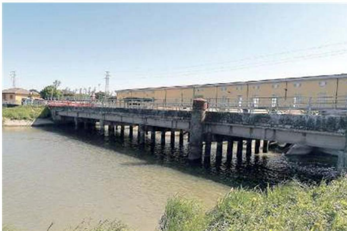
RICOSTRUZIONE Il ponte di Cavanella Po, chiuso al traffico dal maggio del 2021
