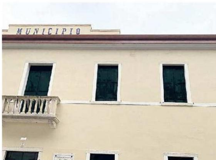
MARTELLAGO Primi segni di deterioramento sulla facciata del Municipio
