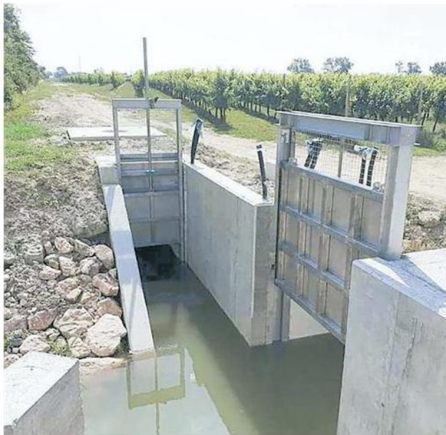
Una centrale di sollevamento del consorzio a Motta
