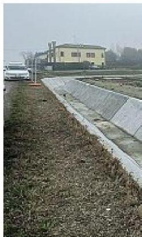
Le opere Canaletta irrigua a Corbola
