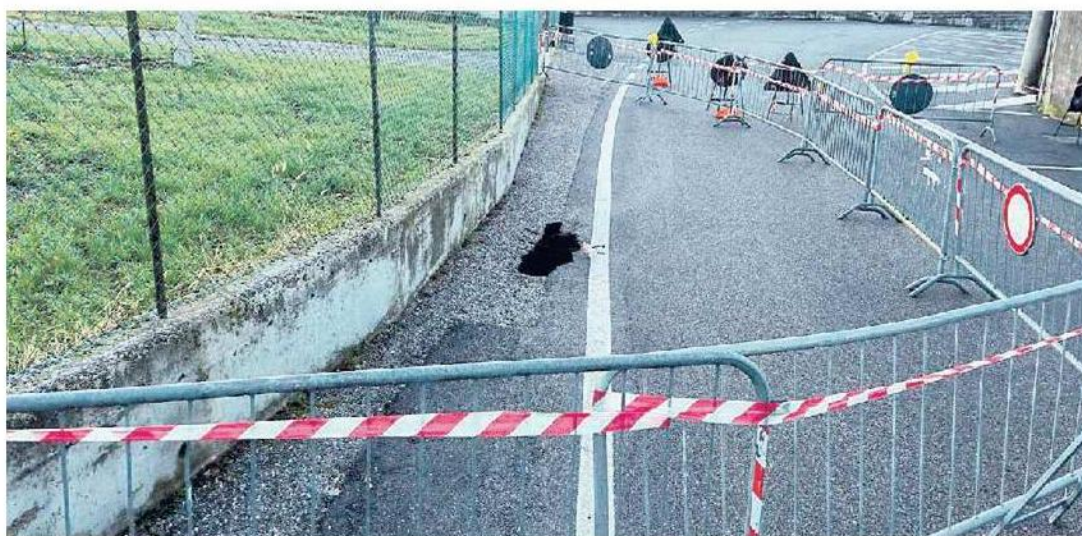
LA CRITICITA' Il buco che si è formato in strada, sotto l'area transennata e a destra la casa con le crepe
