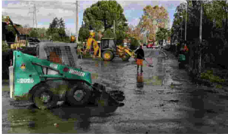
I LAVORI La ripulitura dopo l'alluvione. A destra i sindaci Andrea Marrucci e Giacomo Cucini con il presidente Enrico Rossi a destra
