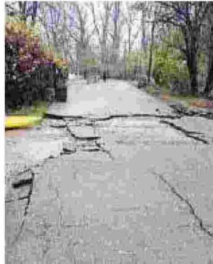
Il manto stradale danneggiato
