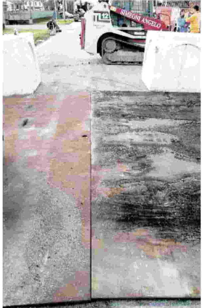
IL TAMPONE Lastre in cemento per garantire il passaggio alternato di auto e motorini, in attesa che si proceda con il ripristino
