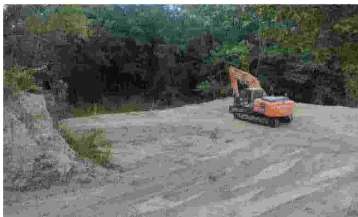
Lavori sulla voragine che si aprì al Parco Ippodromo dopo la piena del Savio
