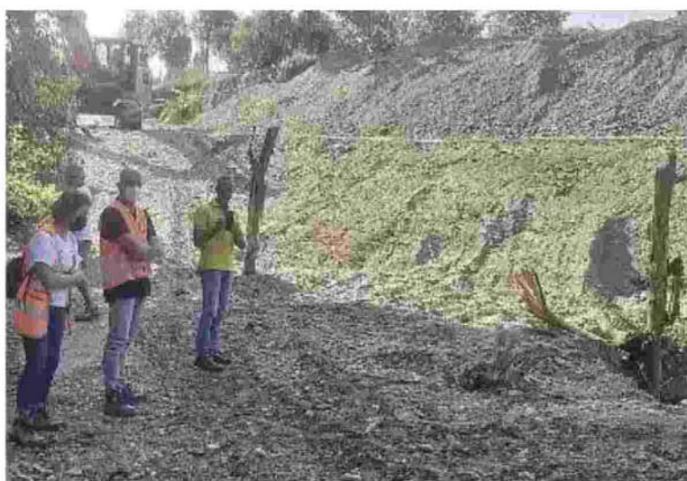
Un sopralluogo sul posto, dove nel maggio 2019 il fiume Savio straripò
