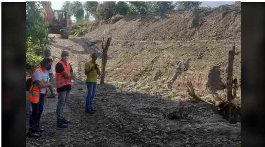
Un sopralluogo sul posto, dove nel maggio 2019 il fiume Savio straripò
