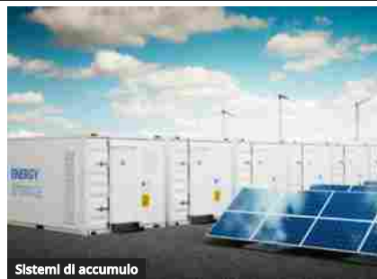
Sistemi di accumulo
