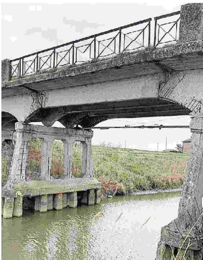
Il ponte della Barchessa è chiuso al transito da più due anni
