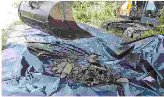
Rifiuti pericolosi Una fase del recupero del materiale con eternit trovato nel torrente Arbia
