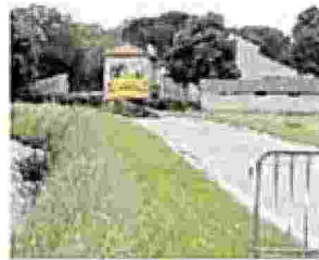
VIA VERDI Il punto dove si è aperta la falla sull'argine
