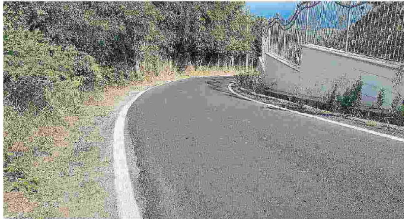
Interpodereale La strada dei Candrilli collegherà il rione Cancello Rosso a Portosalò
