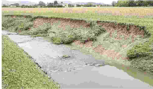
Un tratto di argine dello scolo Menona "mangiato" dal maltempo
