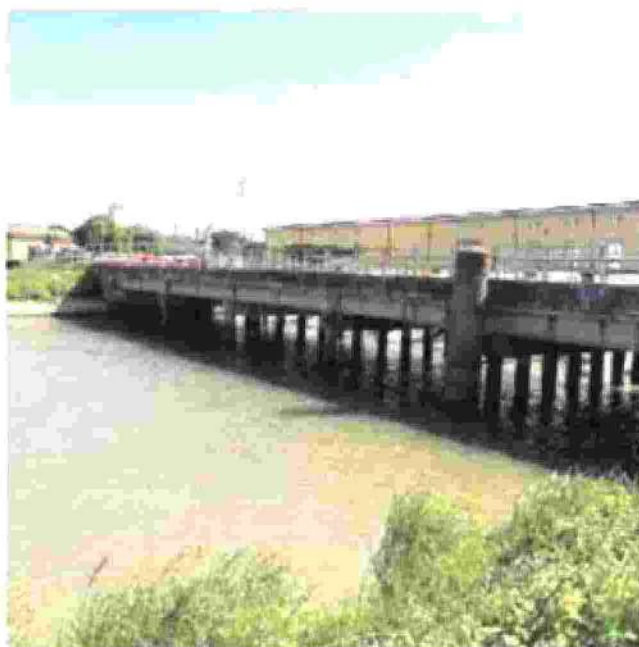
CAVANELLA PO Il nuovo ponte non sarà pronto prima di fine 2022: in alto, uno dei piloni ammalorati della struttura
