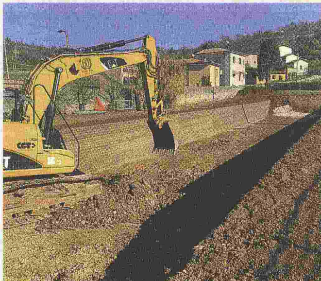
Gli scavi I lavori per realizzare il bacino di contenimento a Parona.
