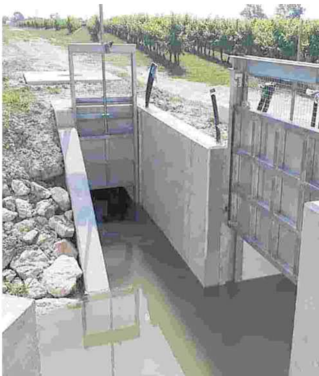
Una delle centrali di sollevamento irriguo del Consorzio
