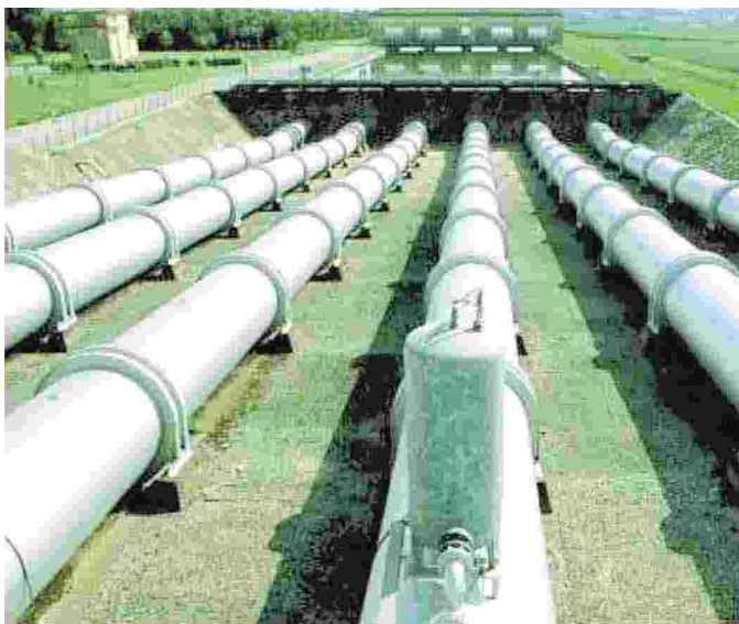
L'impianto di Sabbioncello, del consorzio Burana
