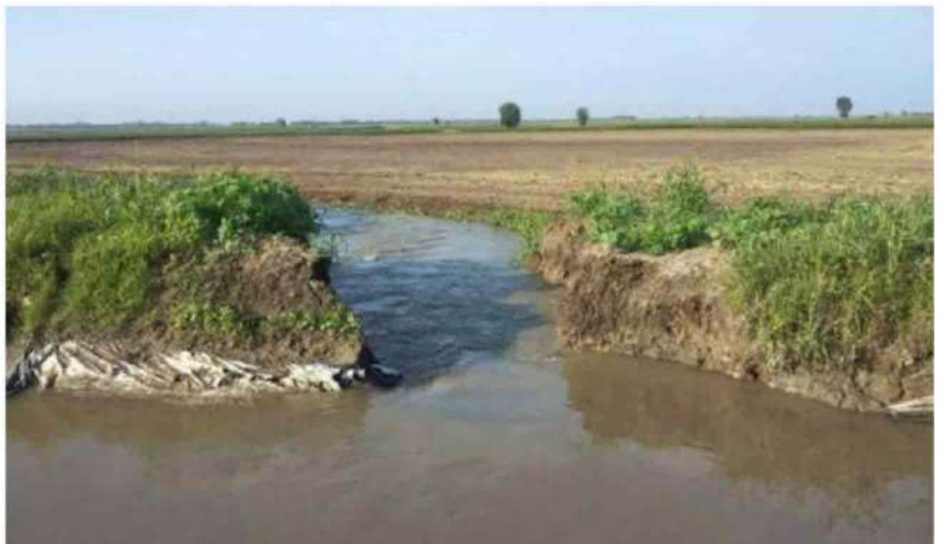
Argine crollato a Torretta Le tane scavate dalle nutrie mettono a rischio le sponde dei fiumi con gravi danni
