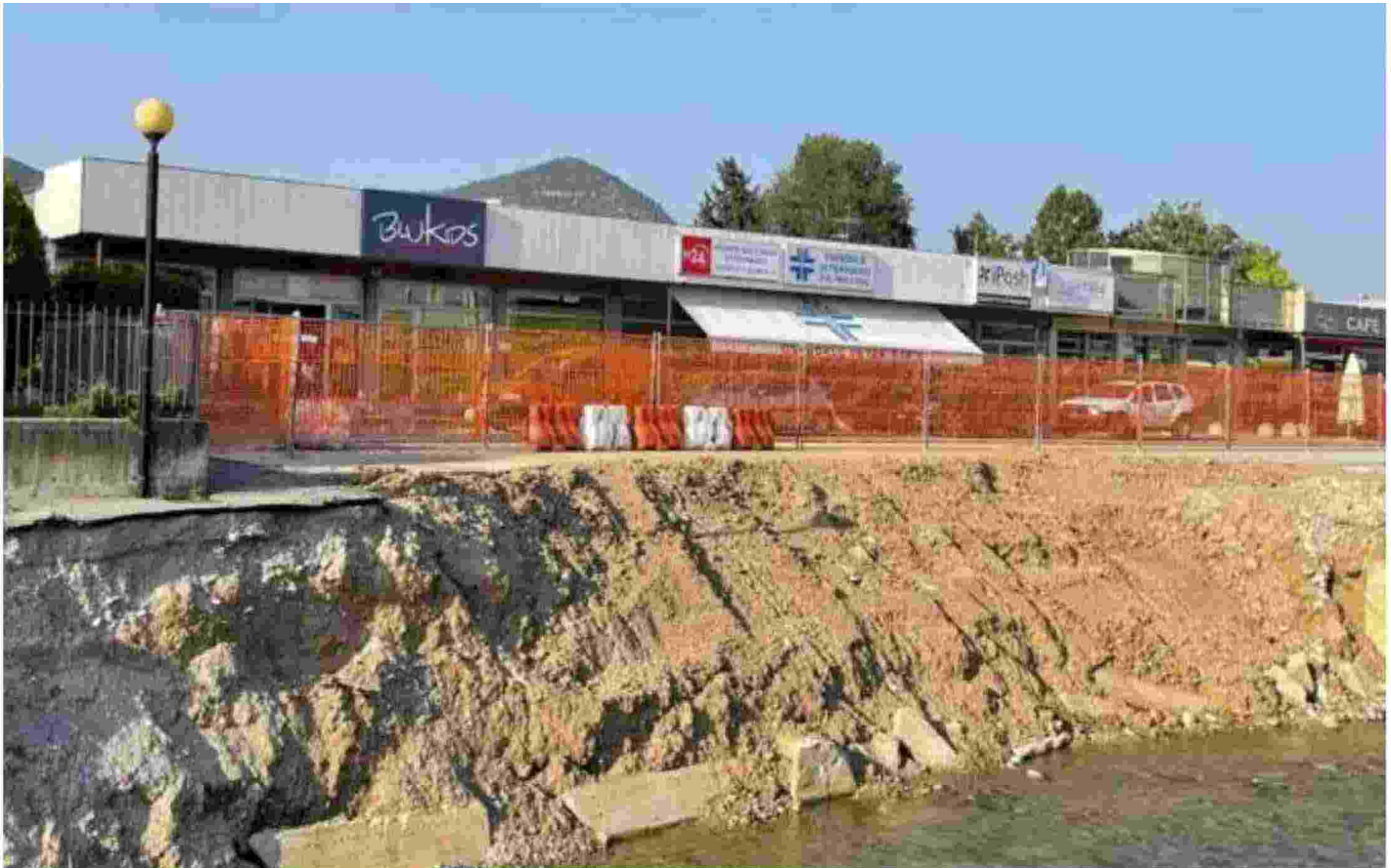
Le sponde Il piazzale che si affaccia sul Naviglio è stato messo in sicurezza. Il 23 maggio si era sbriciolato per effetto di un temporale
