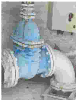
Un impianto per pompare acqua
