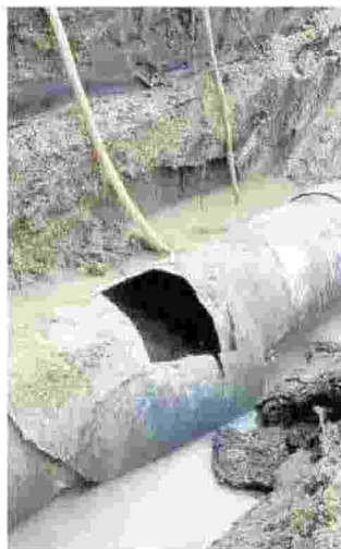
Una condotta ammalorata
