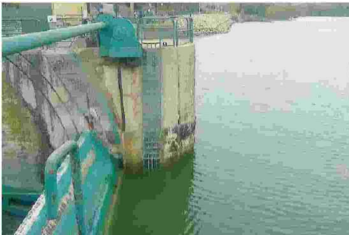
Diga Jato. Uno degli impianti gestiti dal consorzio di bonifica Palermo 2
