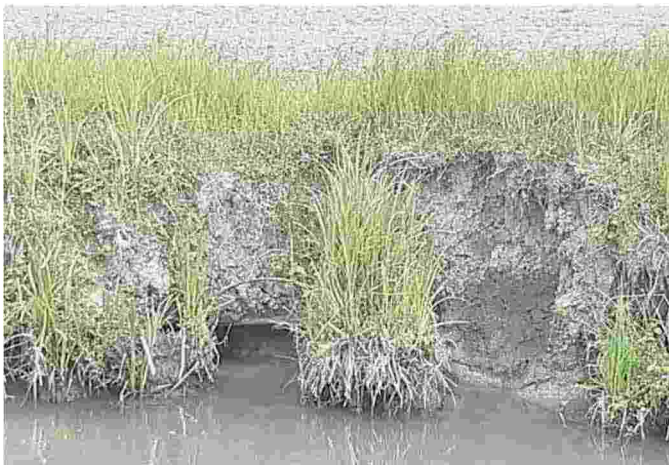
Due tratti di argine con gli evidenti danni causati dalle nutrie
