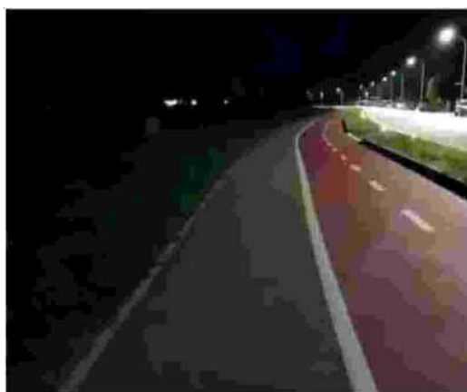
La pista ciclopedonale è al buio, funziona soltanto la luce della vicina illuminazione pubblica
