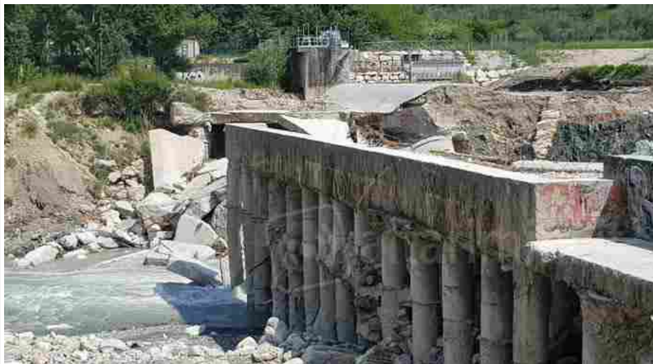
La briglia crollata di Ponte Verucchio, foto del sopralluogo avvenuto il 17 maggio.
