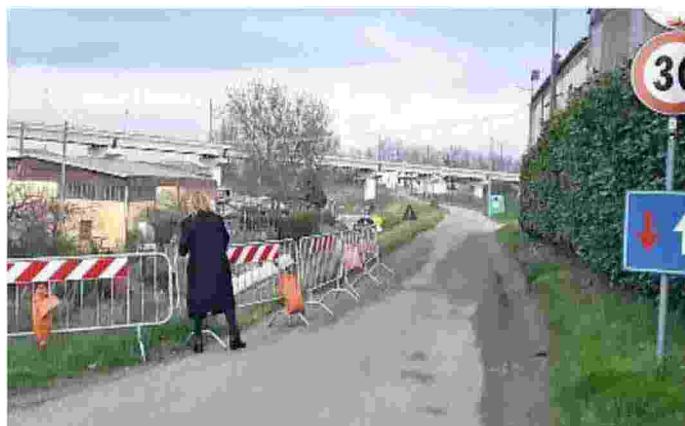
Via delle Rose, una piccola strada caratteristica tra la comunale che collega ad Ospitale e la provinciale, si trova a fare i conti con lo sgretolarsi dell'argine
