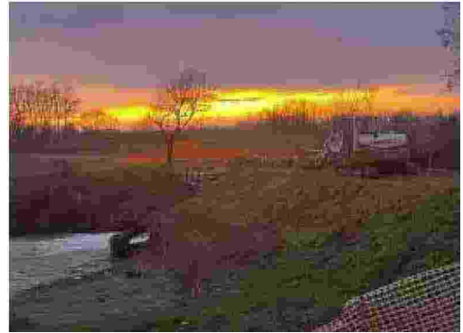
Uno scorcio del cantiere al ponte di Sant'Andrea sul canale Delmona Tagliata
