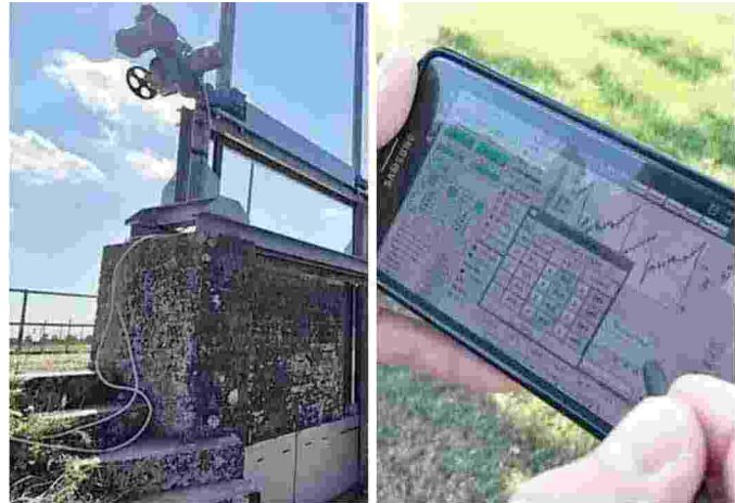
Un manufatto idraulico e il controllo da remoto
