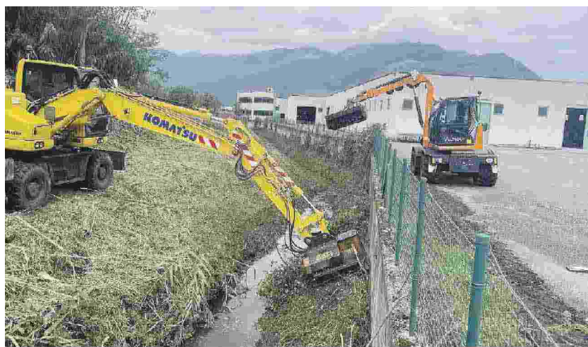
I lavori di bonifica del fosso Campovargino eseguiti dal consorzio "Conca di Sora"
