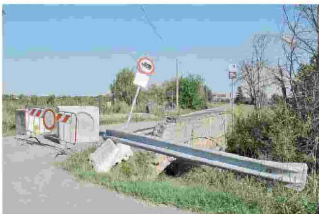
DISAGI Il ponte sul canale Lorno chiuso dal febbraio 2017.
