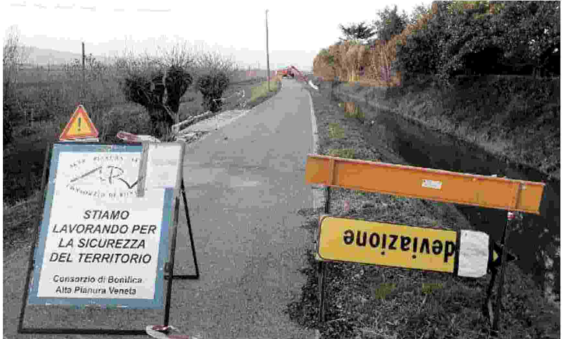
TRANSITO VIETATO Il consorzio di bonifica Alta Pianura Veneta sta lavorando lungo le sponde dello scolo Nina dove passa la pista ciclabile
