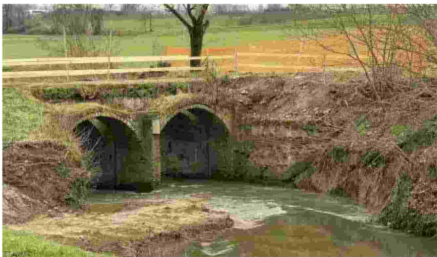
Il ponte di Sant'Andrea a Calvatone è al centro di un importante intervento di recupero dopo che il passare del tempo lo aveva costretto alla chiusura. Il manufatto è molto utilizzato dagli agricoltori
