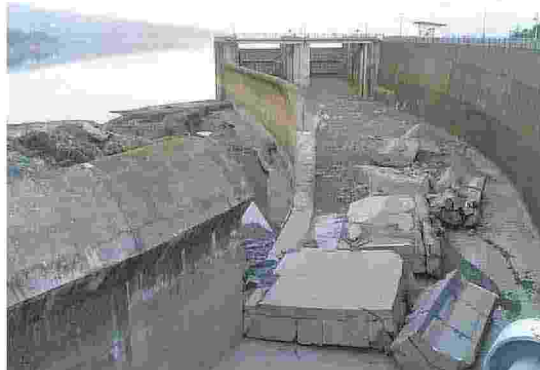
Danni I tre conci che avevano ceduto il 29 dicembre del 2010
