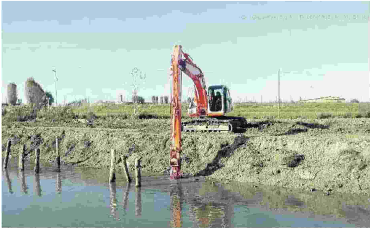
DELTA Uno dei tanti di lavori di sistemazione degli argini effettuato dal Consorzio di bonifica
