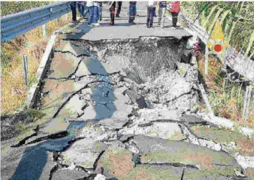
Il crollo in località Difesa | tecnici e gli operai del Consorzio sono a lavoro da due giorni
