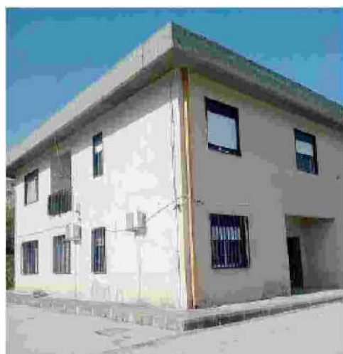
Qui sopra gli uffici della diga Olivo dove sono stati danneggiati alcuni locali; nell'altra foto la Fiat Panda abbandonata tra sterpaglie secche e i tubi di polietilene: potrebbe essere un avvertimento
