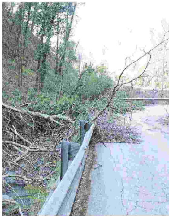
Una frana lungo la strada per Stazzema in una foto di archivio
