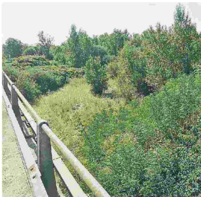
Preoccupa la vegetazione che ostruisce l'alveo del torrente Malina
